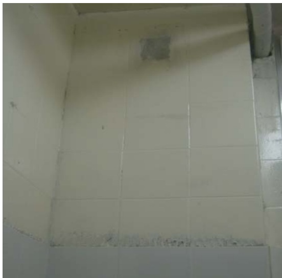
Fig 11 – Banheiro da direção - Dois tipos de azulejo e acabamento ruim.
