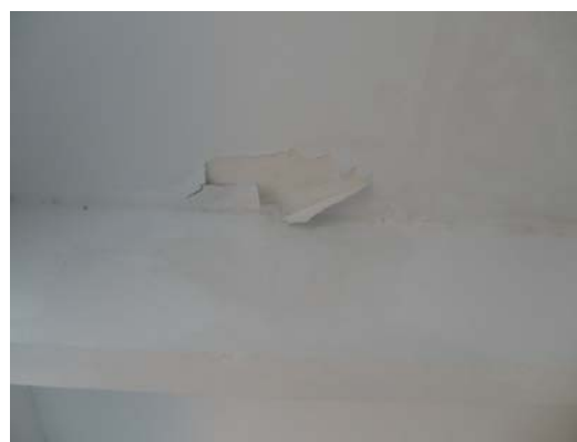
Fig.26 - Corredor do 2ª Pav - Pintura soltando devido a infiltração.
