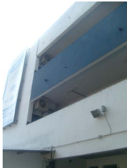
Fig 30 - Fachada - Buzinote jogando água na área externa.
