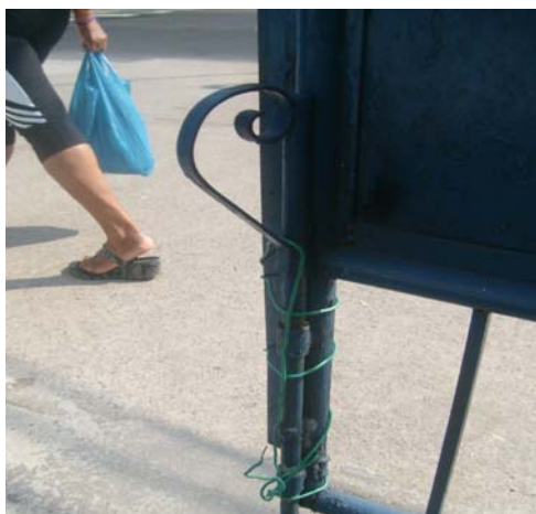
Fig 3: Improvado para fechar os portões que tem um sistema inadequado.
