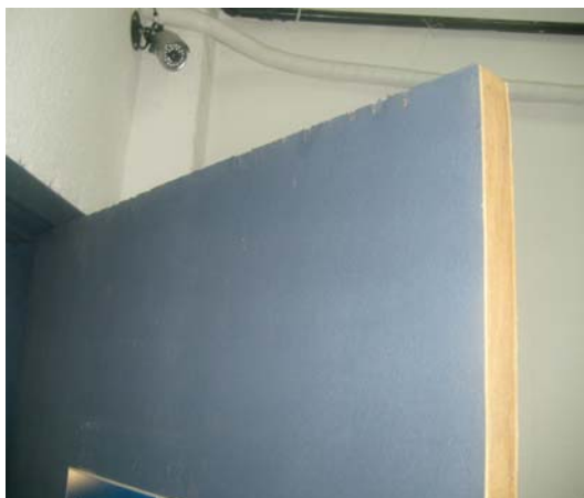
Fig 9: 1ª Pav - Porta danificada e mal pintada.
