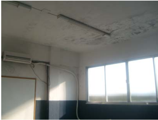
Fig.27 - Sala de aula do 2º Pav - Pintura danificada devido a infiltração.
