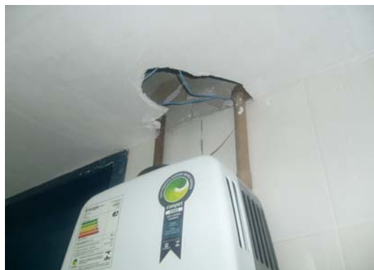
Fig 21 - Cozinha - Buraco no forro de gesso.
