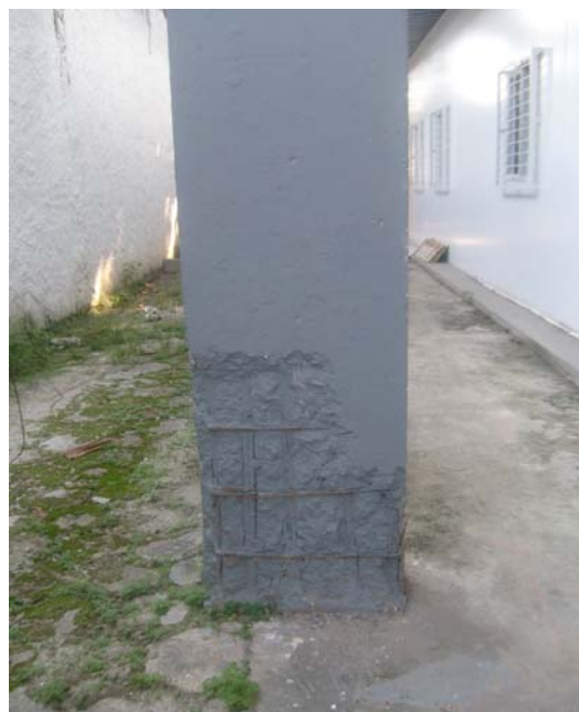
Fig. 16 - Armação aparente sem tratamento necessário.
