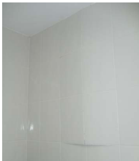
Fig. 23 - Cozinha - Parede estufada
