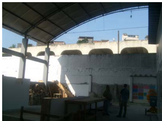
Fig. 17 - Canteiro da Construção Civil - Sem iluminação suficiente.
