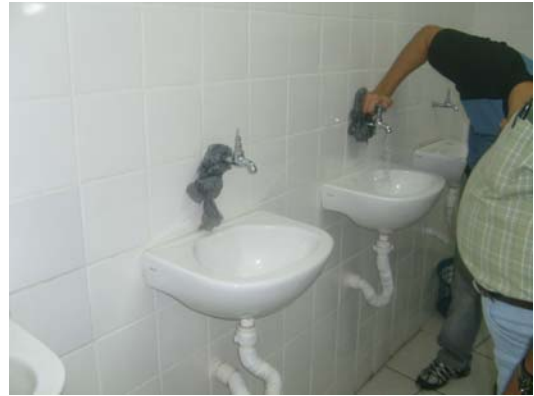
Fig 28 - Pias interditadas devido a vazamento no sifão.
