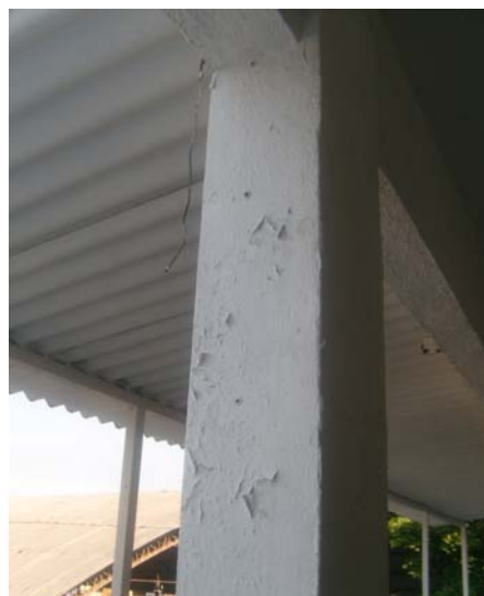
Fig.24 - Corredor 2 do 2ª Pav – Pintura deteriorada.
