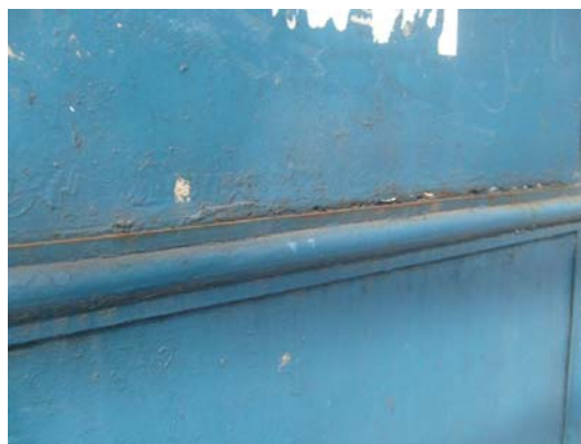
Fig 2: Detalhe do portão danificado por ferrugem
