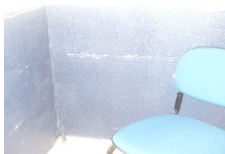
Fig 4: Recepção - Pintura danificada pelo mobiliário.
