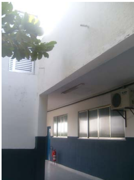
Fig 29 - Fachada – Buzinote jogando água na varanda, escorrendo para sala de aula.
