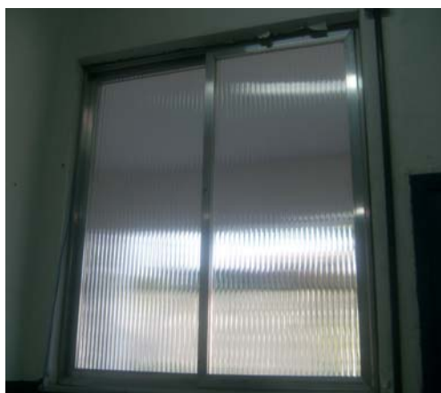
Fig 10: Janela de alumínio sem trinco
