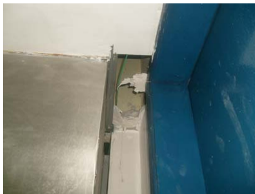
Fig 22 - Cozinha - Buraco no forro de gesso.
