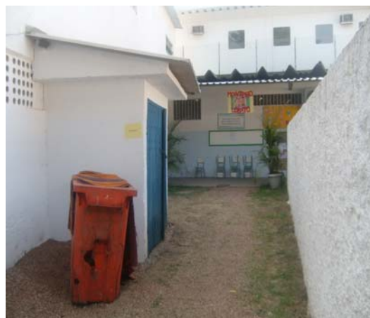
Fig 14 - Abrigo para gás sem ventilação suficiente.
