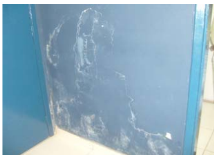
Fig 5: Adm – Pintura danificada pela infiltração.
