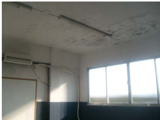
Fig.27 - Sala de aula do 2ª Pav - Pintura danificada devido a infiltração.
