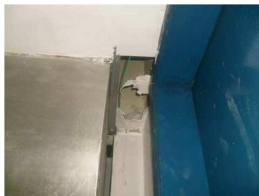
Fig 22 - Cozinha - Buraco no forro de gesso.
