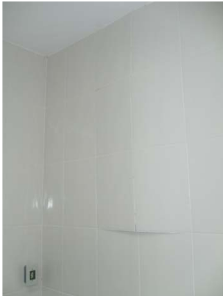
Fig 23 - Cozinha - Parede estufada
