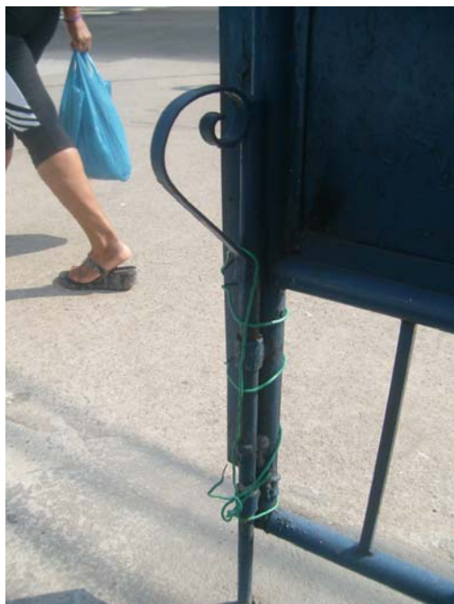
Fig 3: Improviso para fechar os portões que tem um sistema inadequado.
