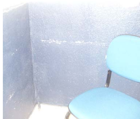
Fig 4: Recepção - Pintura danificada pelo mobiliário.
