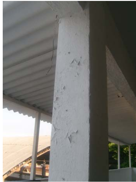
Fig.24 - Corredor 2 do 2ª Pav – Pintura deteriorada.
