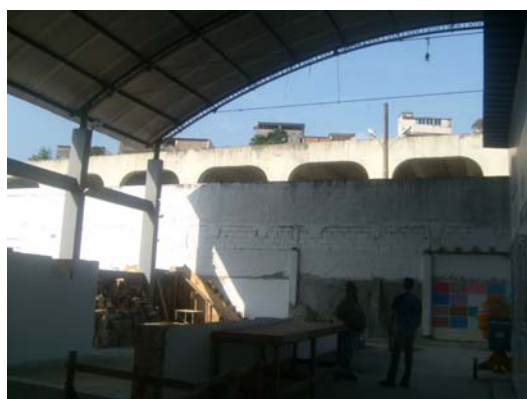
Fig. 17 - Canteiro da Construção Civil - Sem iluminação suficiente.
