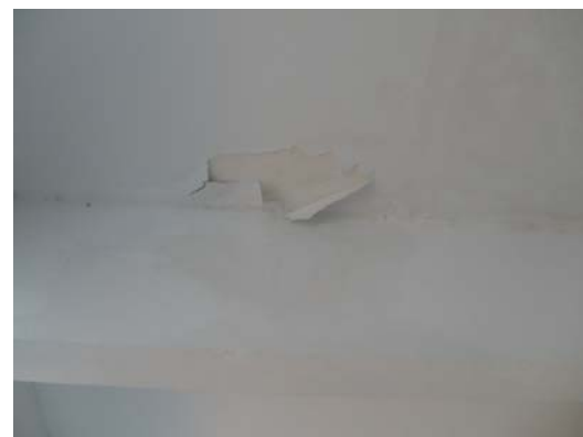
Fig.26 - Corredor do 2ª Pav - Pintura soltando devido a infiltração.
