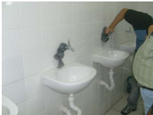
Fig 28 - Pias interditadas devido a vazamento no sifão.
