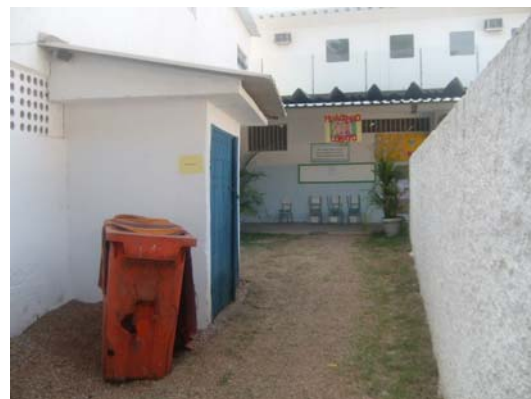
Fig 14 - Abrigo para gás sem ventilação suficiente.
