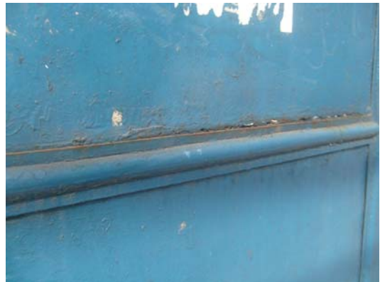
Fig 2: Detalhe do portão danificado por ferrugem
