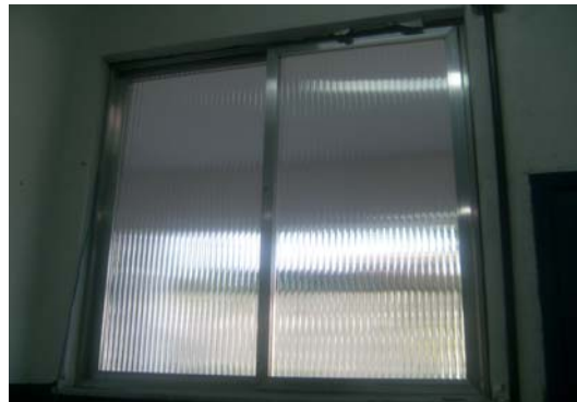
Fig 10: Janela de alumínio sem trinco
