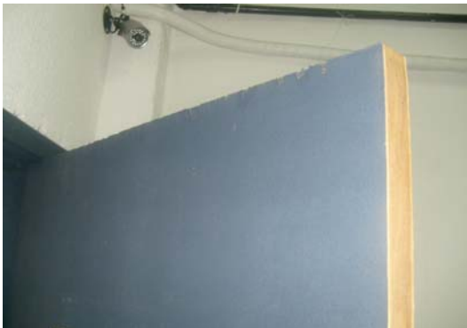
Fig 9: 1ª Pav - Porta danificada e mal pintada.
