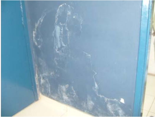
Fig 5: Adm – Pintura danificada pela infiltração.
