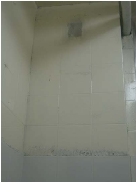
Fig 11 – Banheiro da direção - Dois tipos de azulejo e acabamento ruim.
