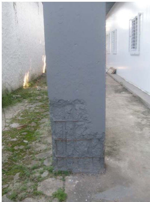
Fig 16 - Armação aparente sem tratamento necessário.
