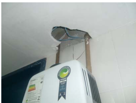
Fig 21 - Cozinha - Buraco no forro de gesso.
