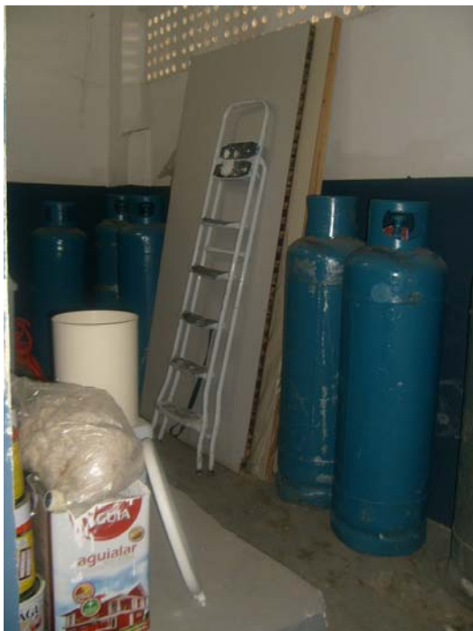
Fig. 15 - Botijão GLP armazenado em local inapropriado.
