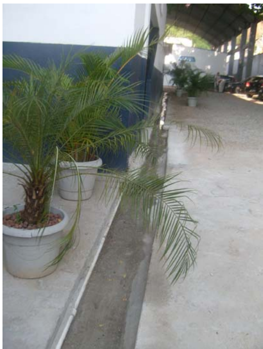
Fig.19 - Área Externa - Vala aberta para escoamento de águas pluviais.
