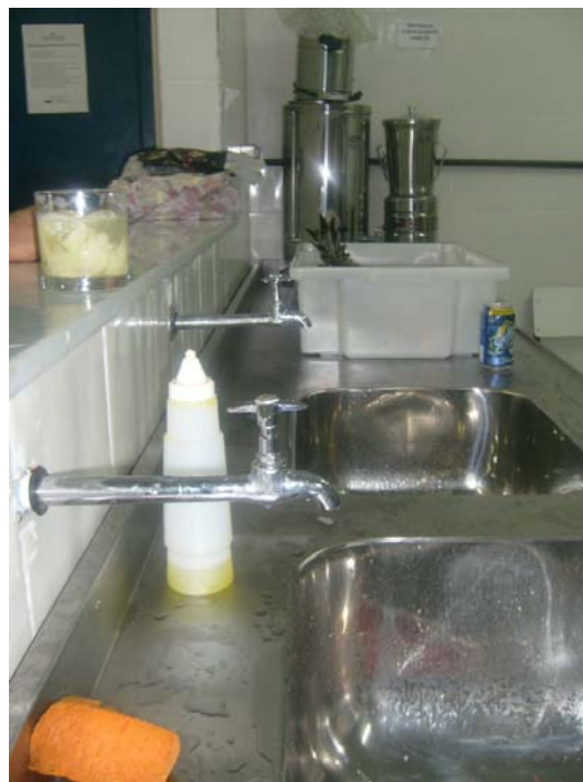
Fig. 20 - Lab. De Barman - Torneiras inadequadas em relação a cuba da pia.
